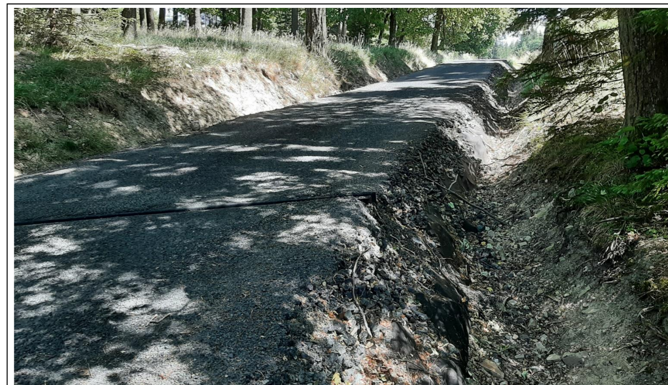
Foto 11 Ukázka nevhodného odvodnění cesty – lokalita 3 Prameniště Třítrubeckého potoka
