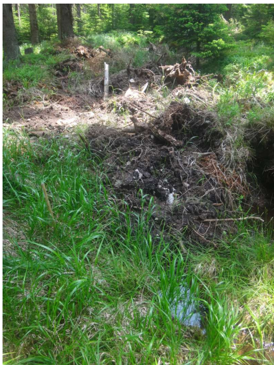
Obr. 5: Vrstevnicový kanál byl také částečně zaspán materiálem z bezprostředního okolí.
